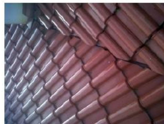
Sobreposição incorreta do rufo.
