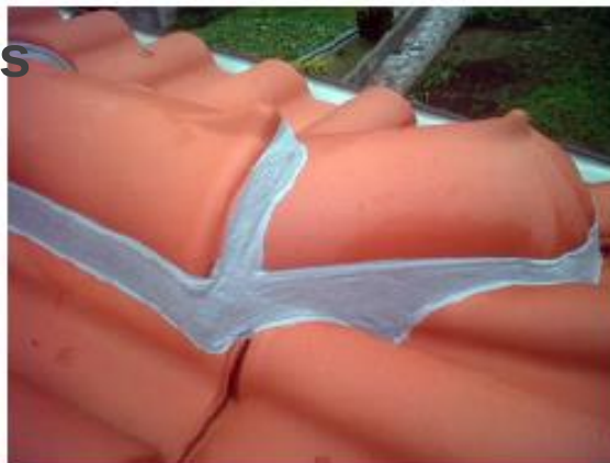
Excesso de argamassa de fixação.
