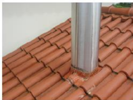
Remate de chaminé mal executado.
