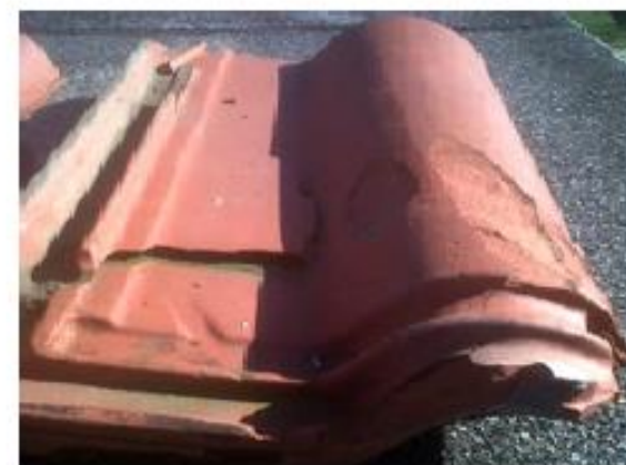
Degradação por ação do gelo.
