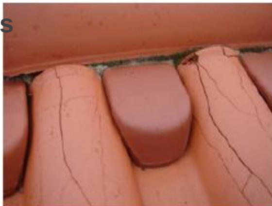
Lascas, fissuras e fendas em telhas cerâmicas.
