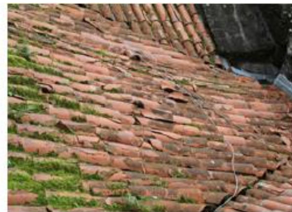
Degradação por ação do gelo.
