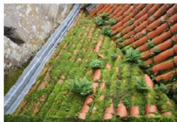
Degradação por ação de musgos.
