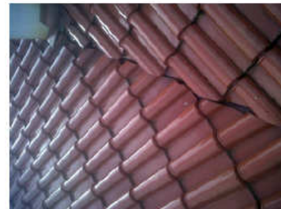
Sobreposição incorreta do rufo.
