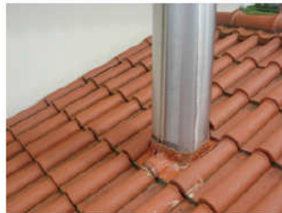
Remate de chaminé mal executado.
