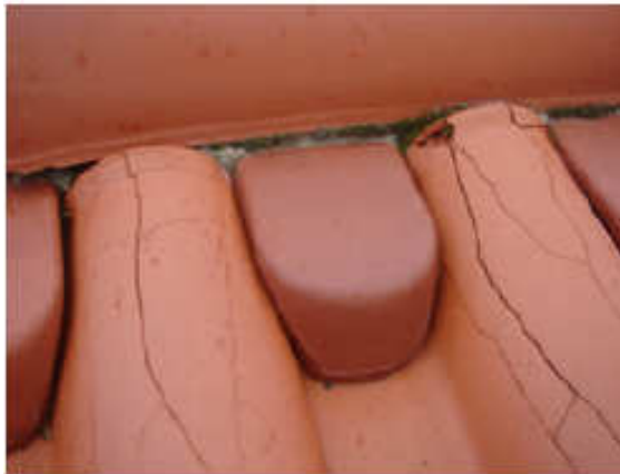
Lascas, fissuras e fendas em telhas cerâmicas.
