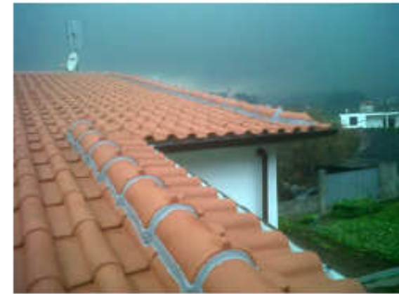
Excesso de argamassa em rincão.
