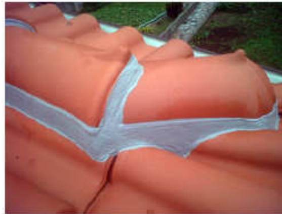
Excesso de argamassa de fixação.
