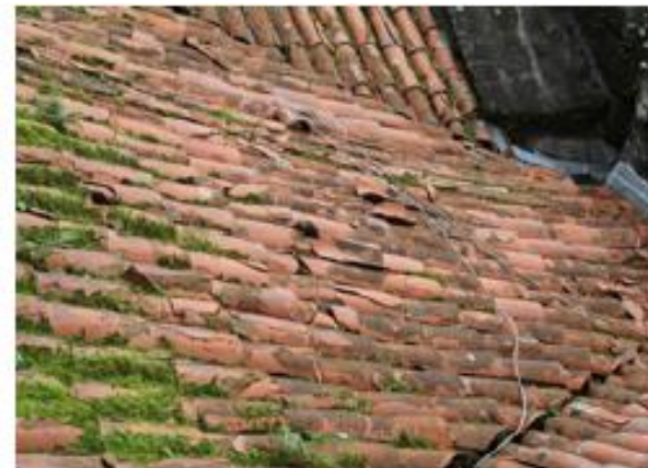
Degradação por ação do gelo.
