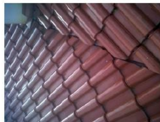
Sobreposição incorreta do rufo.
