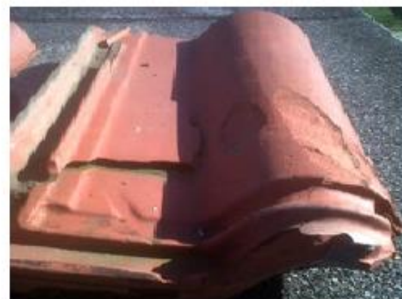
Degradação por ação do gelo.
