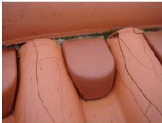
Lascas, fissuras e fendas em telhas cerâmicas.
