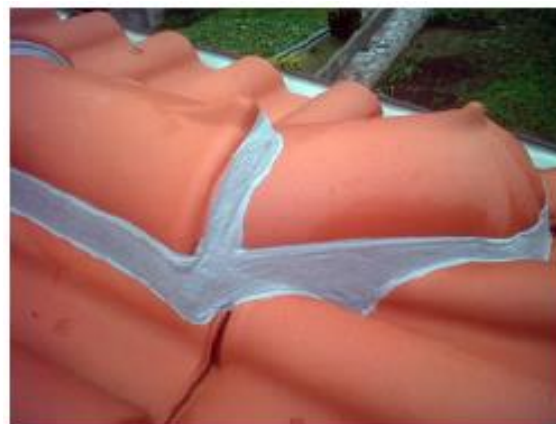
Excesso de argamassa de fixação.
