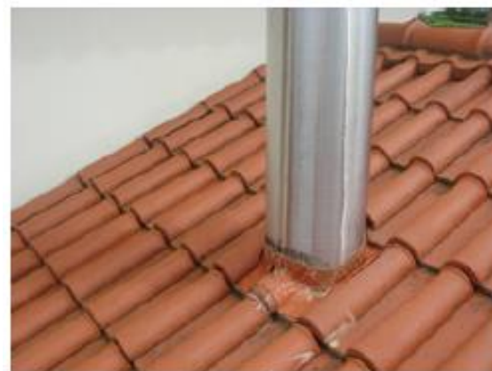
Remate de chaminé mal executado.
