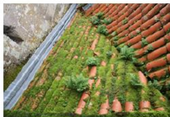
Degradação por ação de musgos.
