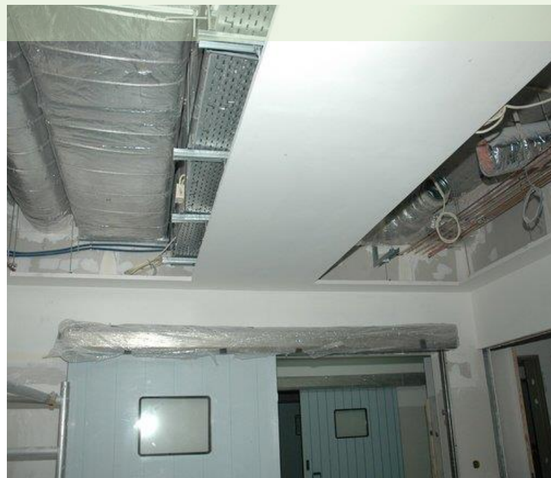
Condutas de ar condicionado
