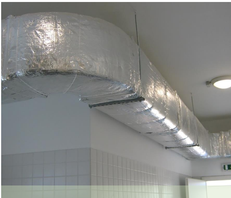
Condutas de ar condicionado
