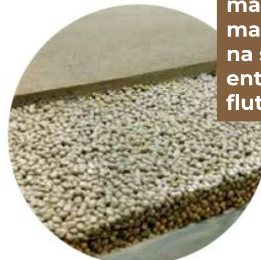
3 Após 24 horas o piso está apto para a colocação da betonilha final.
