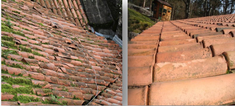
Descasque das telhas por ação do gelo/degelo.
