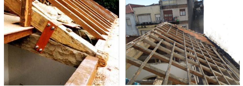
Degradação da estrutura e materiais acessórios.
