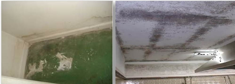
Condensações de vapor de água pelo interior.
